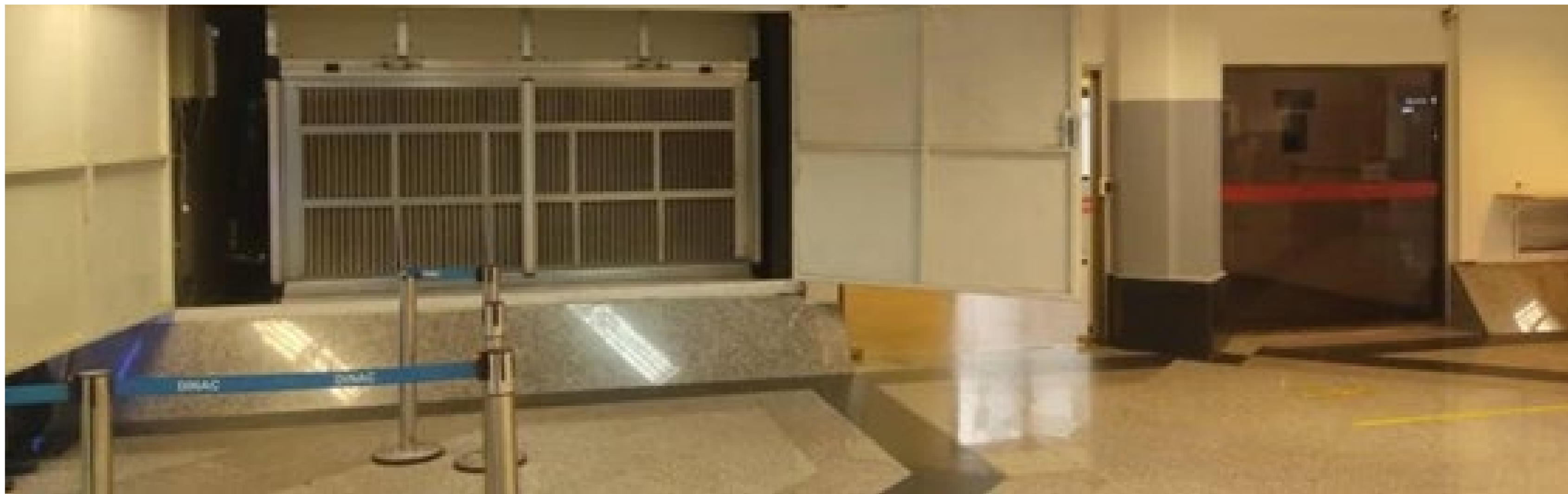
ADQUISICIÓN Y PUESTA EN MARCHA DE EQUIPOS UMAS - ÁREA RESTRINGIDA DEL AISP
